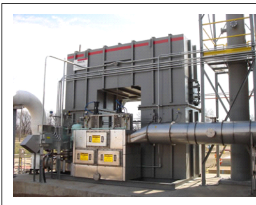
축열식 연소산화 (Regenerative Thermal Oxidizer 11 )
